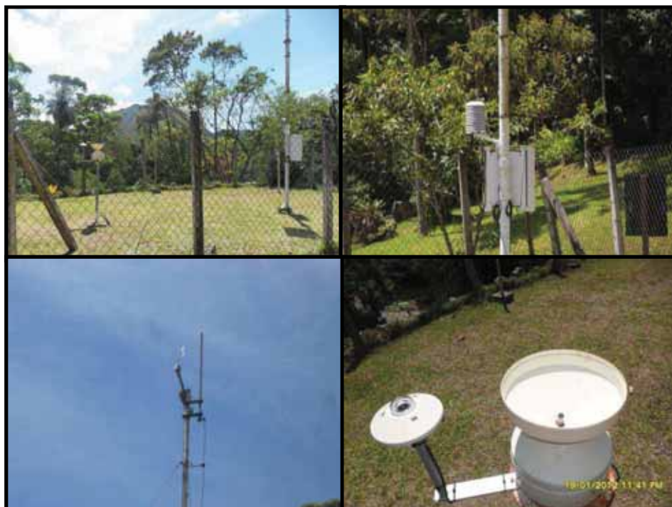
Figura 5.10 – Estação meteorológica de Teresópolis e os equipamentos instalados.
